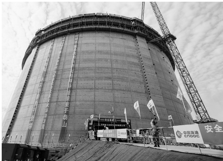
9月22日，国内在建规模最大液化天然气储备基地主体结构基本完成。 新华社发
