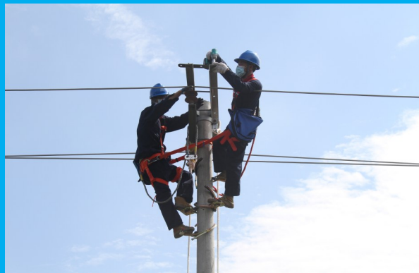
近日,国网广宗县供电公司10千伏琵琶线083路进行检修维护工作,夯实该条线路2个村庄800余户居民安全稳定用电基础,保障秋检工作取得实效,护航冬季取暖用电稳定。(祝振甲)
