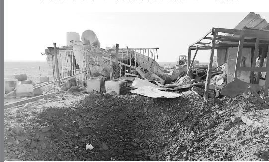
这是2019年12月30日在伊拉克安巴尔省加伊姆镇拍摄的袭后的建筑物废墟。伊拉克联合行动指挥部当月29日证实，美国无人机当地时间晚7时对伊拉克安巴尔省靠近叙利亚边界的加伊姆镇一处什叶派民兵武装“人民动员组织”据点实施了空袭。
