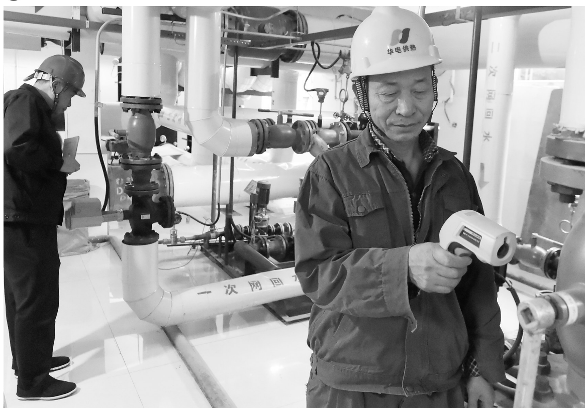
11月14日下午,石家庄华电供热集团有限公司工作人员在用点温计测量换热机组供回水温度。记者 史晟全/摄
