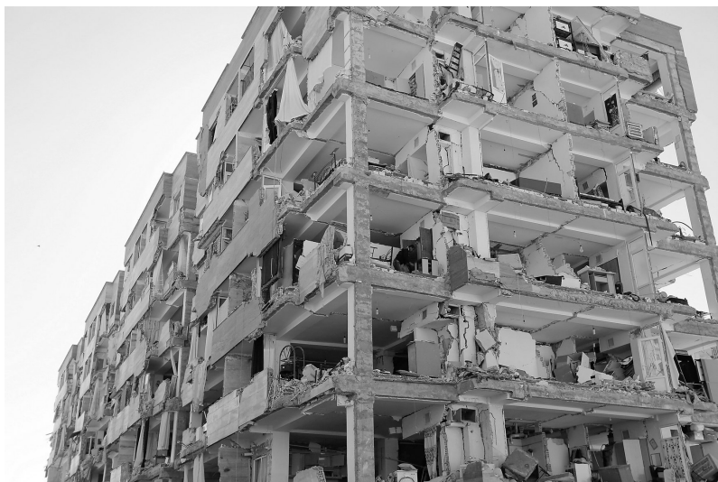
11月13日,在伊朗的克尔曼沙阿省,一栋建筑被地震损坏。新华社/路透
