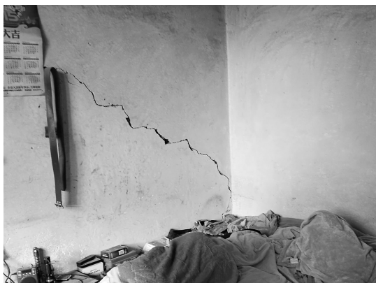
牛志平家墙上裂开了大缝隙
